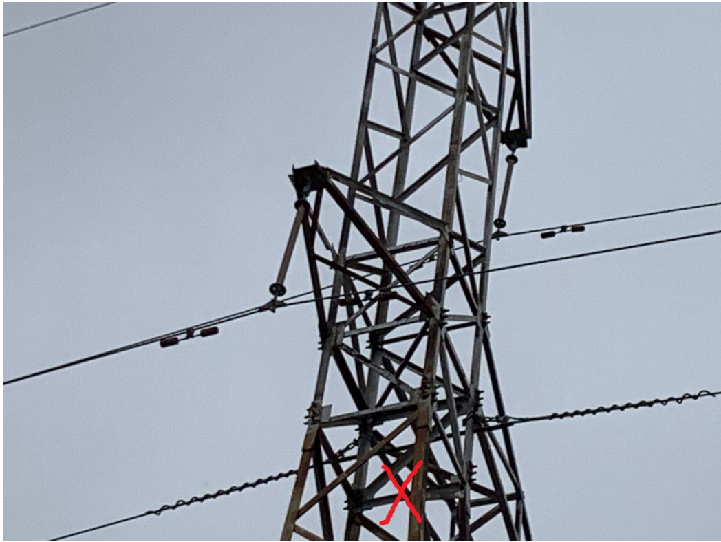
Рисунок 5. Проблема с натяжением кабеля ВОЛС на опоре №6
